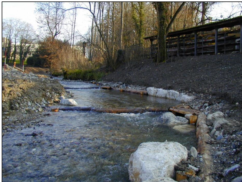
Lit majeur lors des travaux avec talutage et réfection de la berge naturelle
